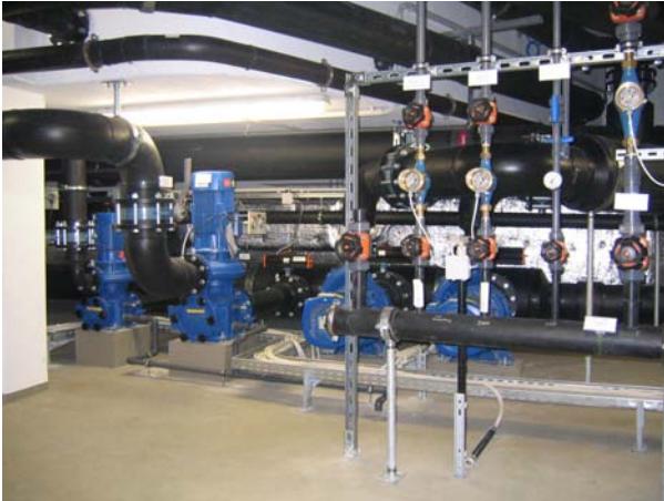
Attraktionspumpen Badewasser und Brunnenwassernachspeisung
