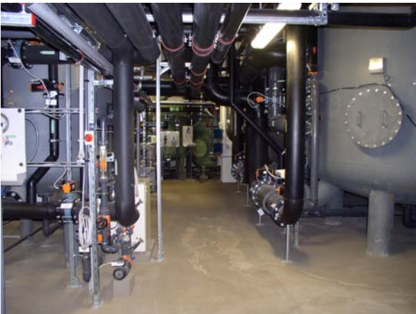
Filteranlagen der Badewasseraufbereitung
