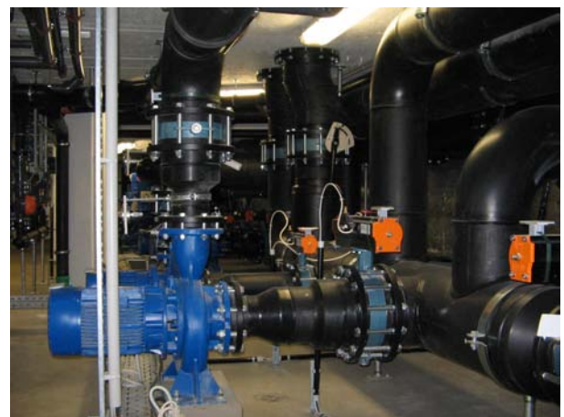
Attraktionspumpen Badewasser Thermalsole Außenbecken
