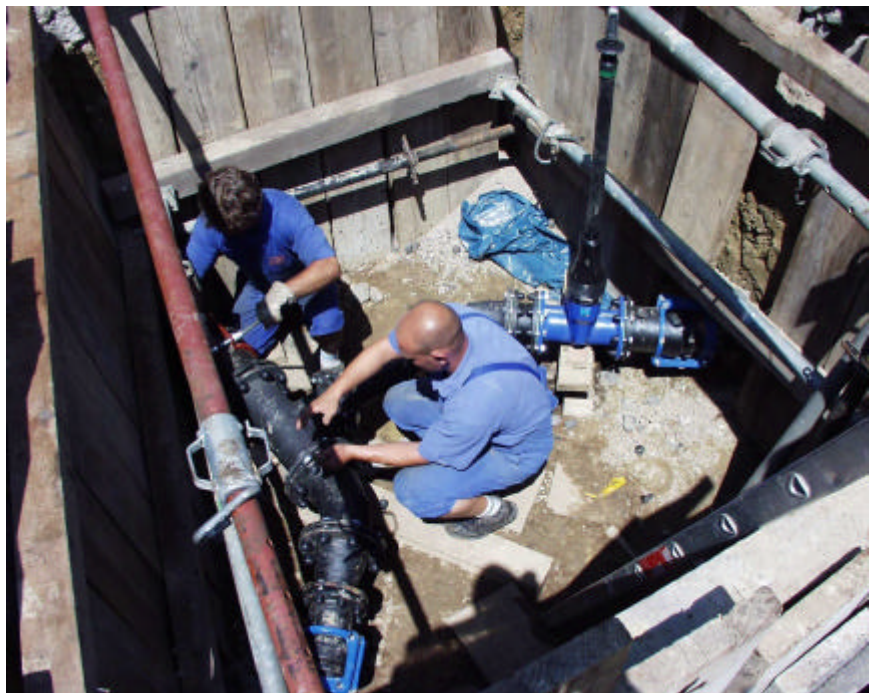
Nicht nur bei der Wassereinbindung sind die Arbeitsabläufe für Kalkulation und Abrechnung stark vereinfacht und verkürzt
