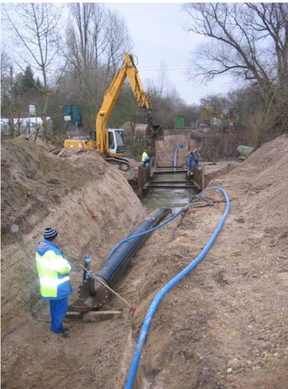
Wasserversorgungsleitung nach Altrip
